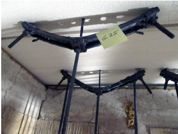
Abb. 1b: Stark verformte MÜPRO MPR-Systemschiene nach der Brandprüfung.
