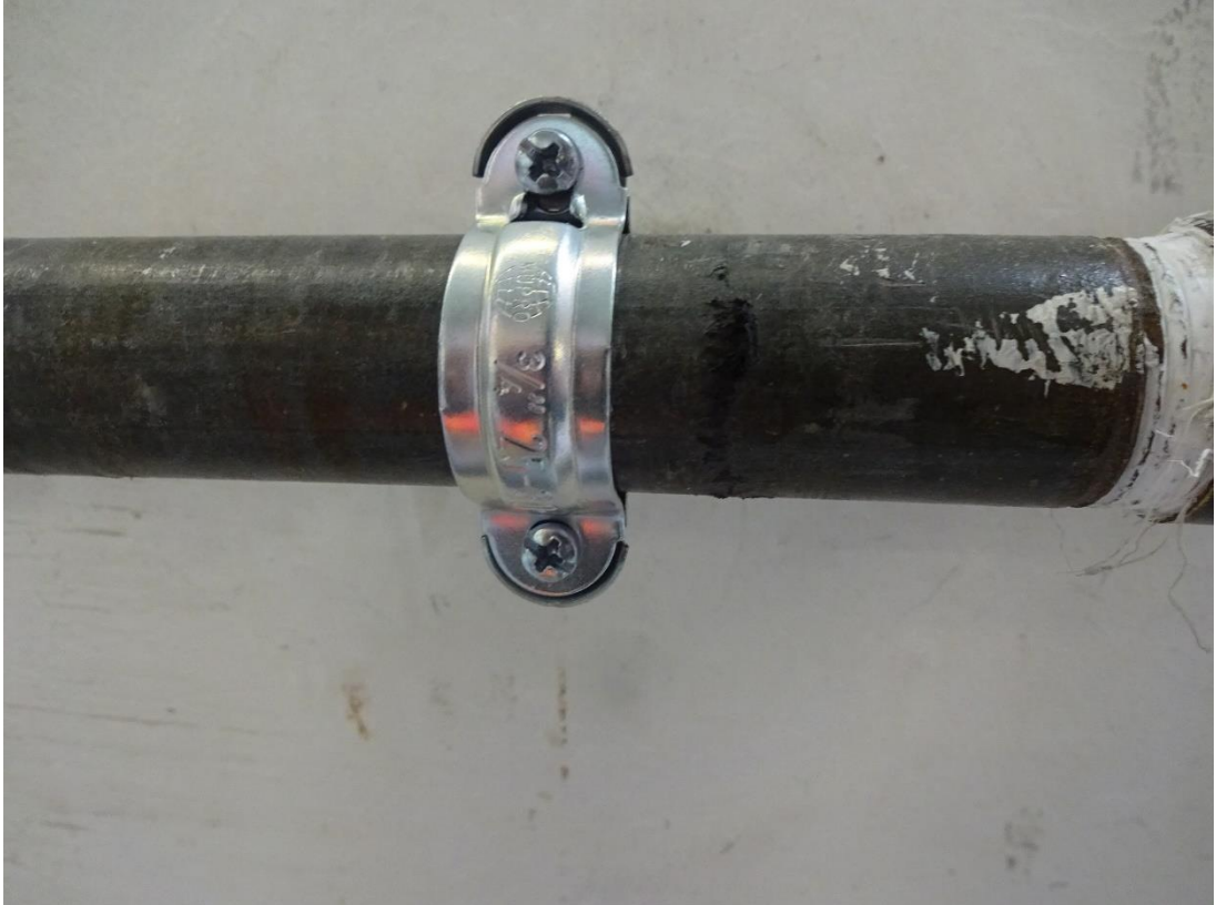
Bild 1: Bezugsmessung: OPTIMAL DÄMMGULAST®, 3/4" (25 - 30 mm), Anschluss M10, starrer Anschluss
