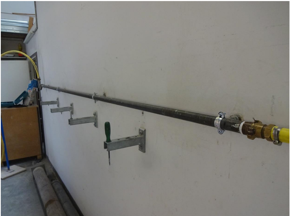
Bild 2: Bezugsmessung: OPTIMAL DÄMMGULAST®, 3/4" (25 - 30 mm), Anschluss M10, starrer Anschluss
